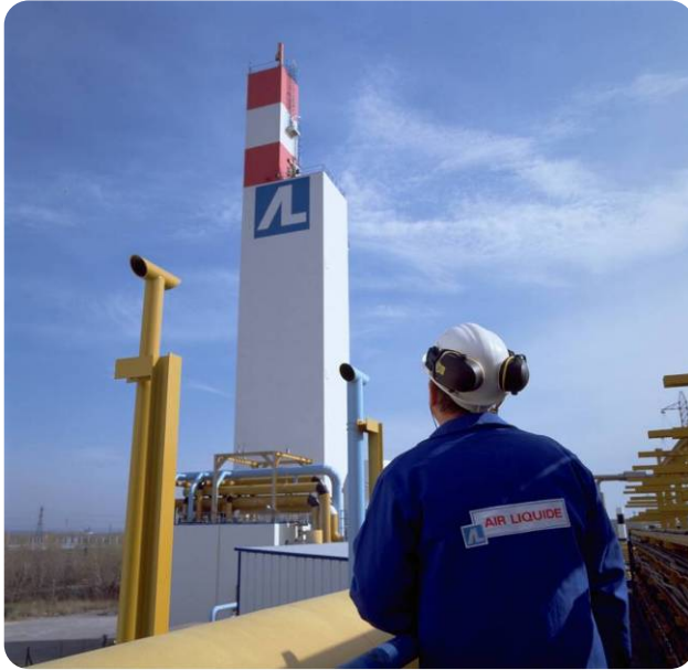
Unidade de Separação dos gases da Air (ASU)
